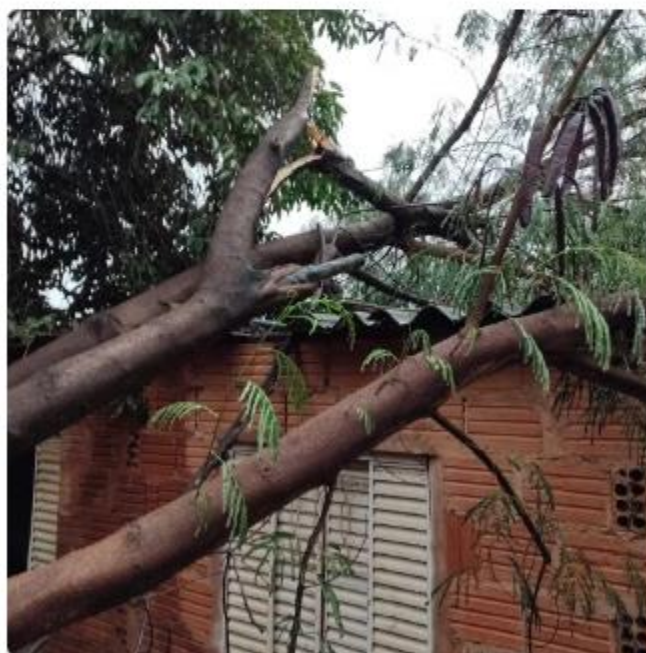
Árvore caída em cima de casa — Foto: Corpo de Bombeiros
