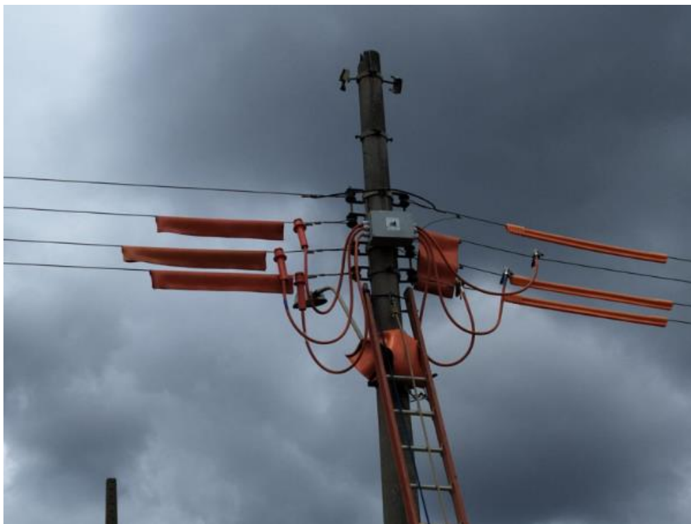
Foto 02: Interligação com By-pass Com Disjuntor
