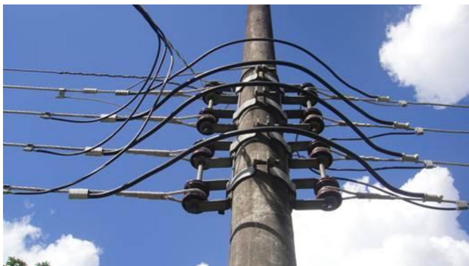
Foto 1 – Interligação com By-pass Sem Disjuntor
