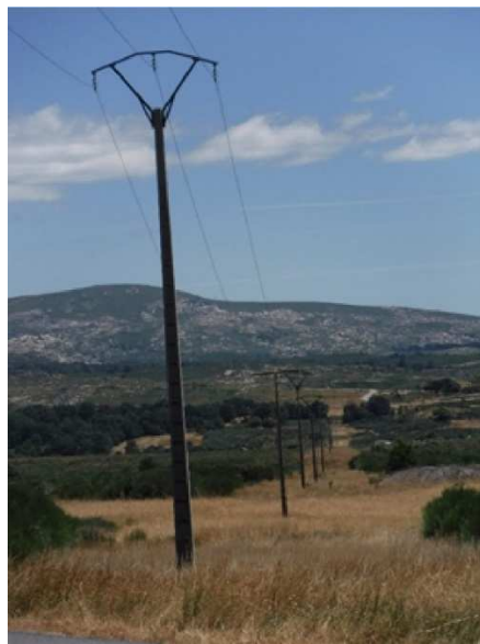
Figura 42 - Faixa de gestão de combustível da rede elétrica em média tensão.
