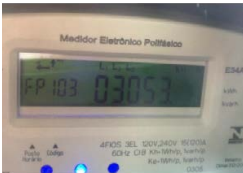
Figura 6 Foto do medidor de energia mostrando o registrador FP103 para leitura da energia injetada.
