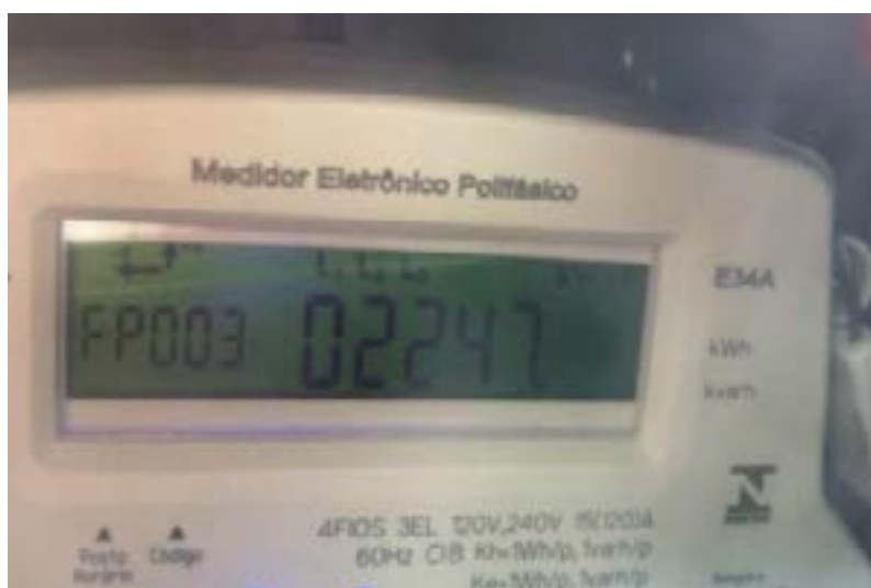
Figura 5 Foto do medidor de energia mostrando o registrador FP003 para leitura da energia consumida da rede de distribuição.
