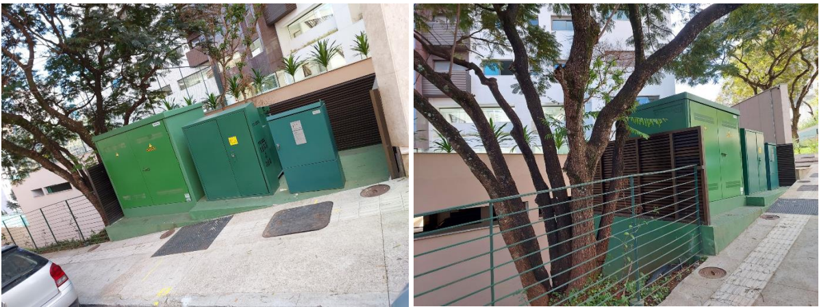
Foto: Chave de MT, Transformador e Quadro de Baixa Tensão instalados em Pedestal
