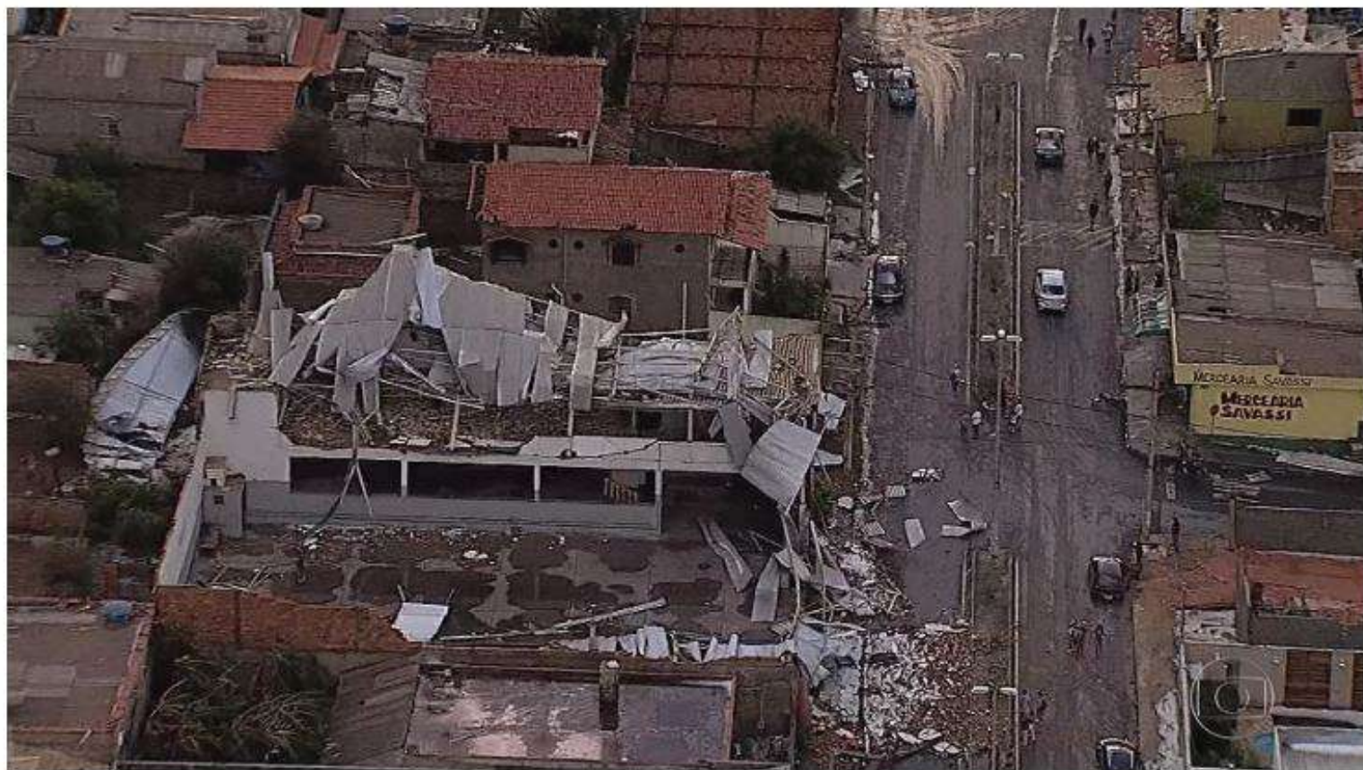
Vários imóveis foram destelhados durante a chuva em Ribeirão das Neves — Foto: Reprodução/TV Globo
